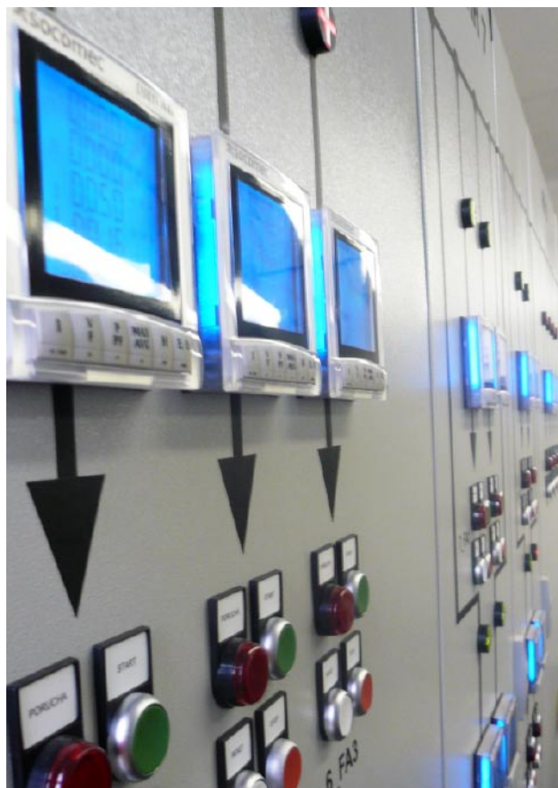
nová rozvodna NN
